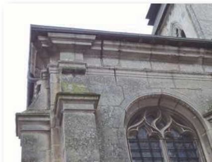
Lézarde sur corniche Nord
