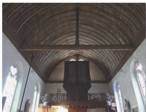
Travées 1 et 2 80 % douvains à remplacer.
