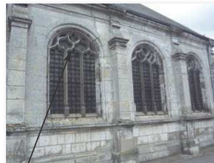
Lézarde pose d'un tirant à envisager
