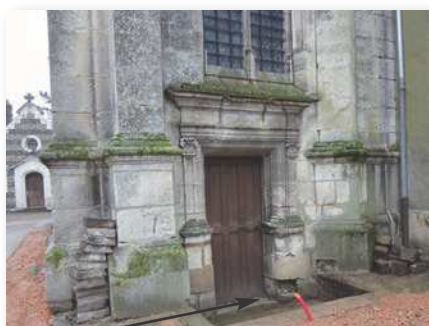
Morceau de maçonnerie manquant
