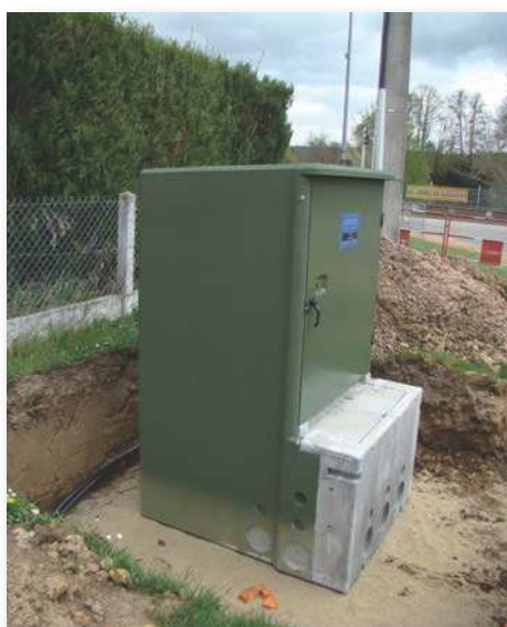
Nouvel équipement électrique
