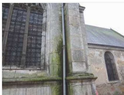
Maçonnerie endommagée par fuite descente d'eau
